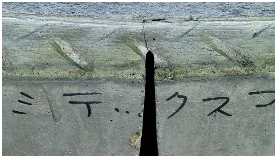
クラック部分の拡大写真
